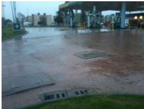
Fotografía 6. Área y cunetas de recolección sin conexión a tratamiento hacia la carrera 64
